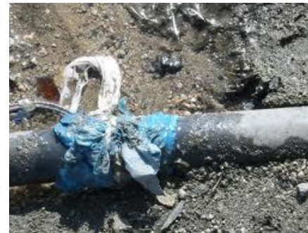
Altas pérdidas de agua
