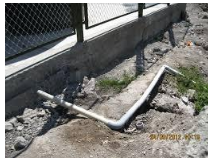
Falta de medición -conexiones directas
